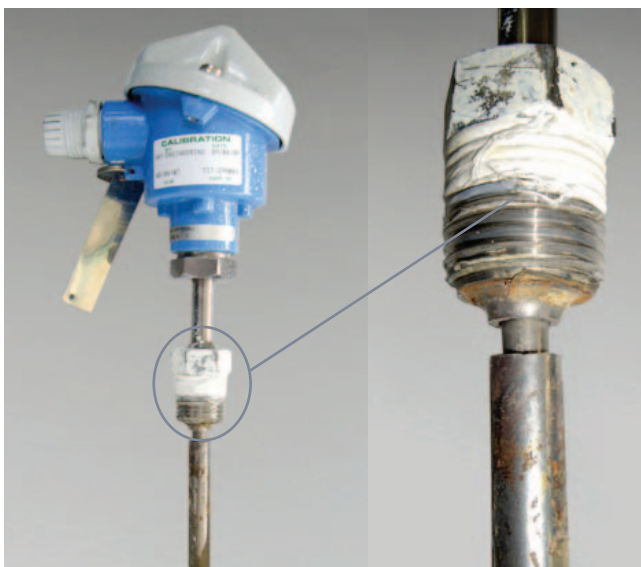
Ein geschweißtes Schutzrohr mit 9mm Durchmesser und 270mm Eintauchlänge, eingebaut in eine Wasserleitung. Es brach aufgrund von Resonanzschwingung.
